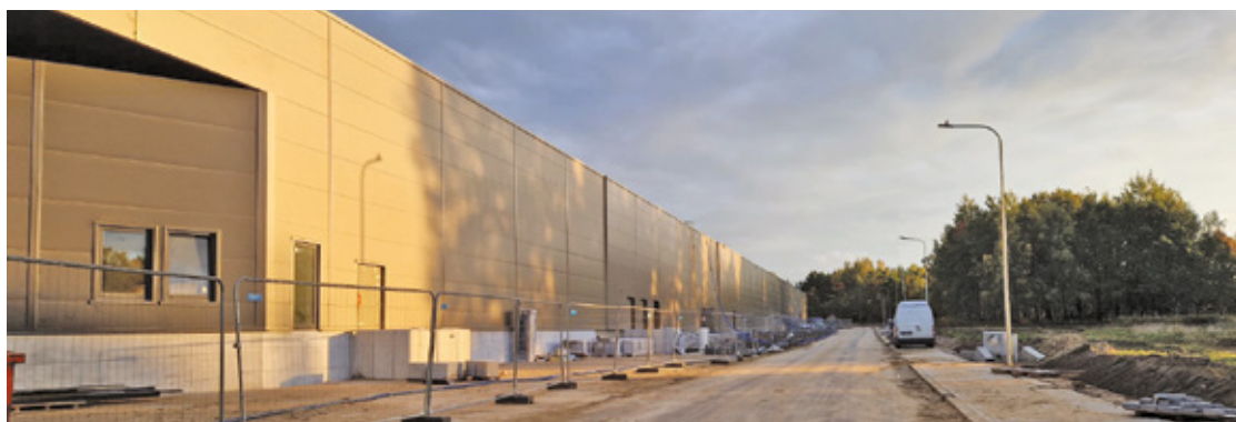
Ul. Żeromskiego na wysokości S17 i ul. Sołtana
