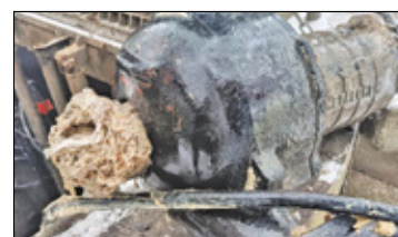
/// Osieck - Awaria kanalizacji w gminie s. 5
