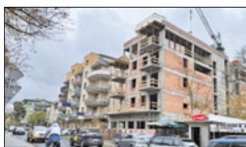
/// Otwock – Wypadek na budowie s. 7
