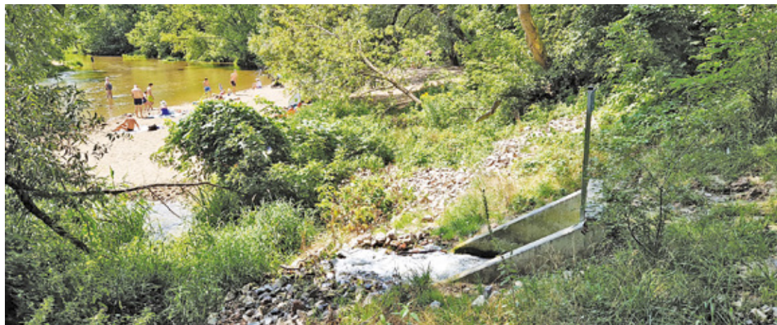
Ścieki są odprowadzane z oczyszczalni w Józefowie rurą do rzeki Świder
