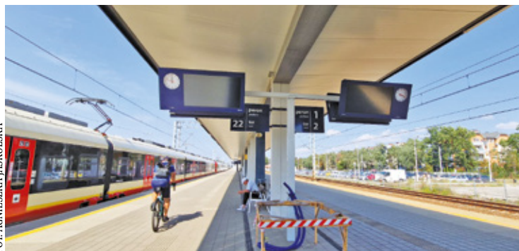
Na peronach zamontowano łącznie 46 wyświetlaczy LCD, system nagłośnienia oraz monitoring
