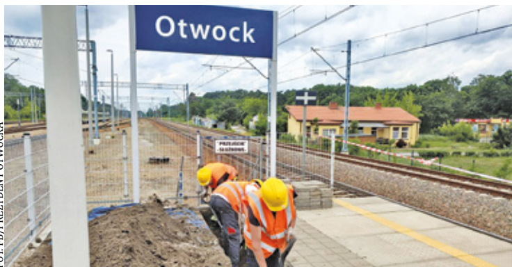
Na peronach będzie m.in. monitoring i ekrany LCD z bieżącymi informacjami
