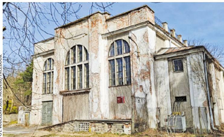
Konserwator ocenił, że stan degradacja dawnej elektrowni jest wyjątkowo wysoki. Natomiast biegły – po wykonanych pomiarach – uznał, że zawilgocenie ścian przekracza 20% nasycenia wodą struktury muru
