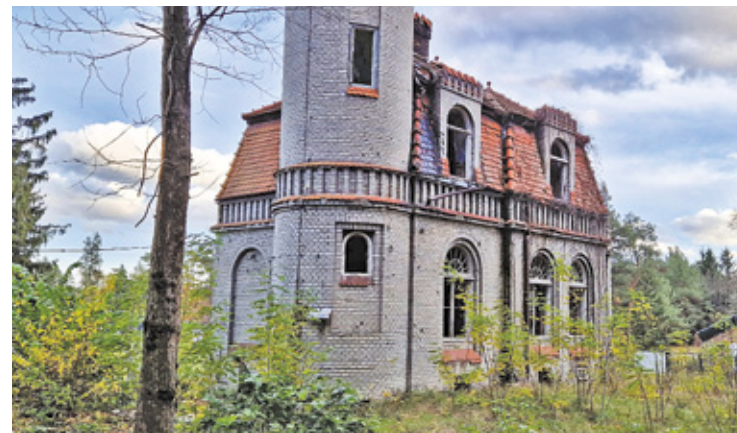
Mazowiecki Wojewódzki Konserwator Zabytków nakazał właścicielowi zabytkowego obiektu przeprowadzenie prac konserwatorskich i robót budowlanych
